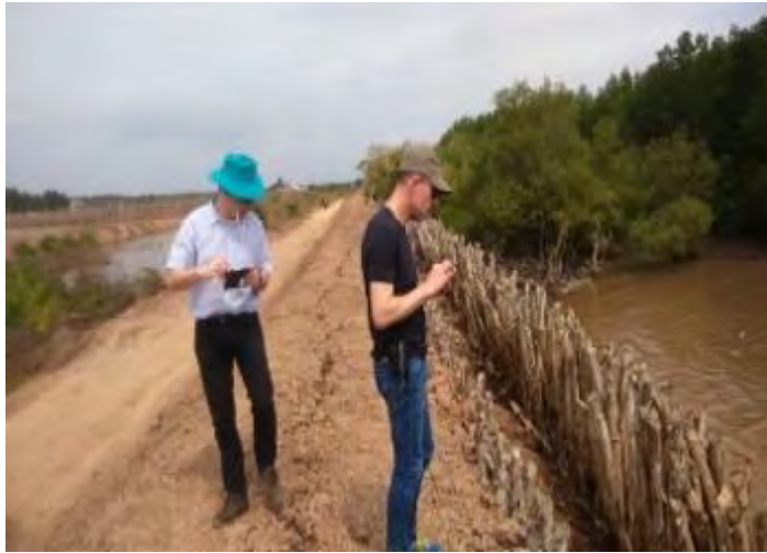
Hình 30. Đê đất với kè hàng rào đôi bằng gỗ Nguồn: Stefan Groenewold
