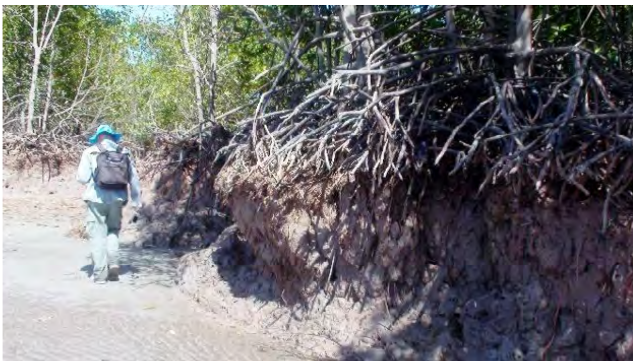
Hình 58. Vách đất xói lở ở bờ biển Tây – Cà Mau. Lớp đất có rừng ngập mặn bị xói chân và sụp xuống. Thực tế cho thấy tình trạng không còn gì sót lại phía trước của vách đất xói lở là một dấu hiệu của một quá trình xói lở nhanh và mạnh. Nguồn: Stefan Groenewold
