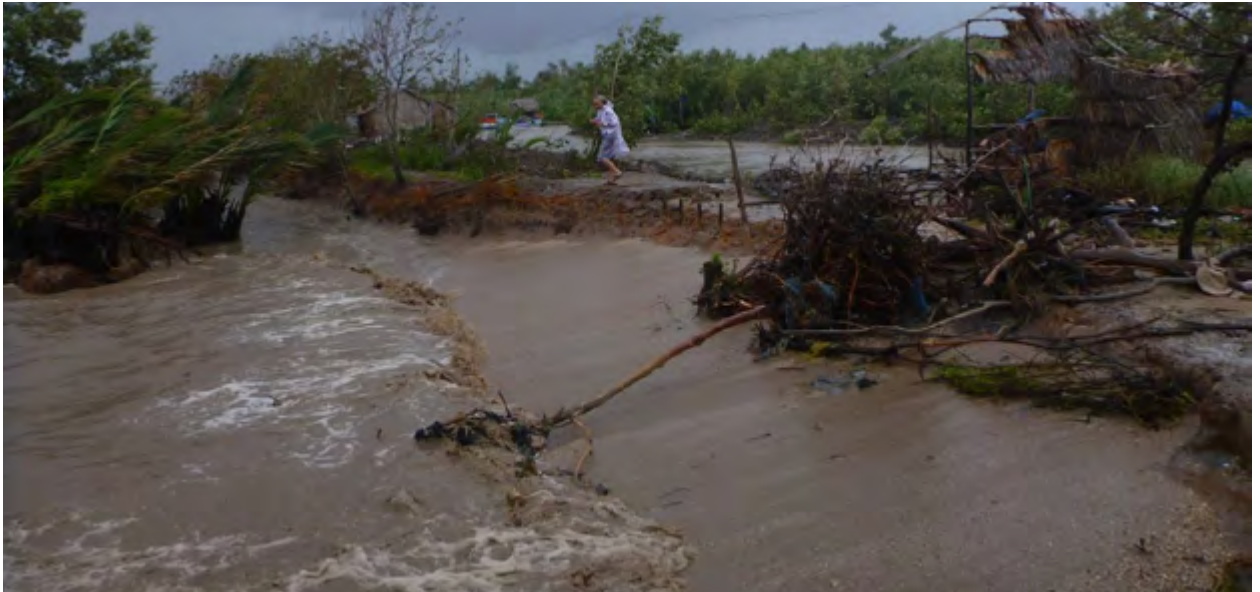
Hình 7. Xói lở tiến gần đến tuyến đê ở Cà Mau trong mùa mưa bão. Nguồn: Stefan Groenewold
