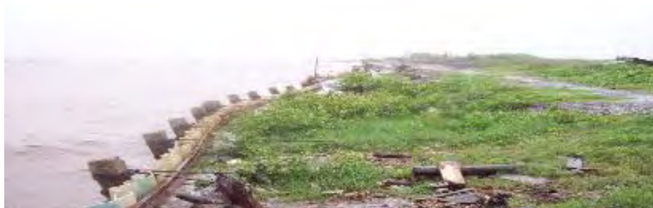
Hình 23. Kè lát mái bờ biển, tấm PVC. Nguồn: Phan Thanh Tĩnh
