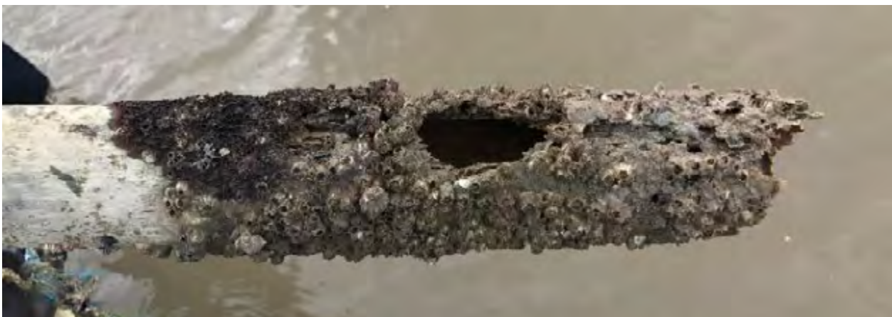
Hình 56. Cọc tre bị con hà ăn hỏng. Con hà ấu trùng bám lên bề mặt gỗ (tất cả các loại gỗ), đục và ăn sâu vào gỗ trong quá trình sinh trưởng của nó. Các con hà khi lớn sẽ không gây hại và đục vào gỗ. Nguồn: Stefan Groenewold
