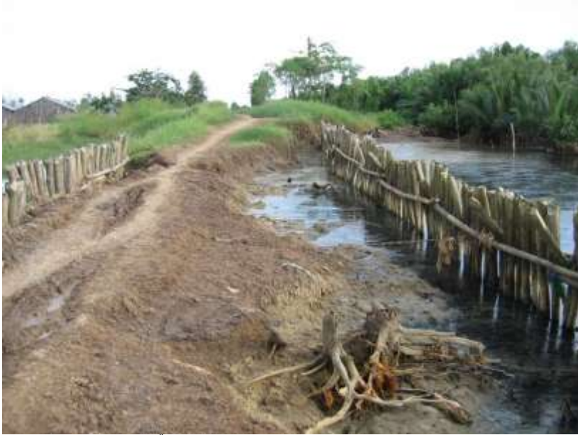
Hình 13: Đê bị đổ sập
