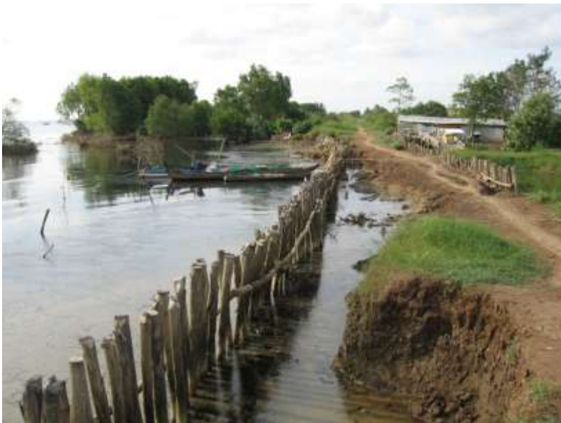
Hình 14: Đê bị ăn mòn
