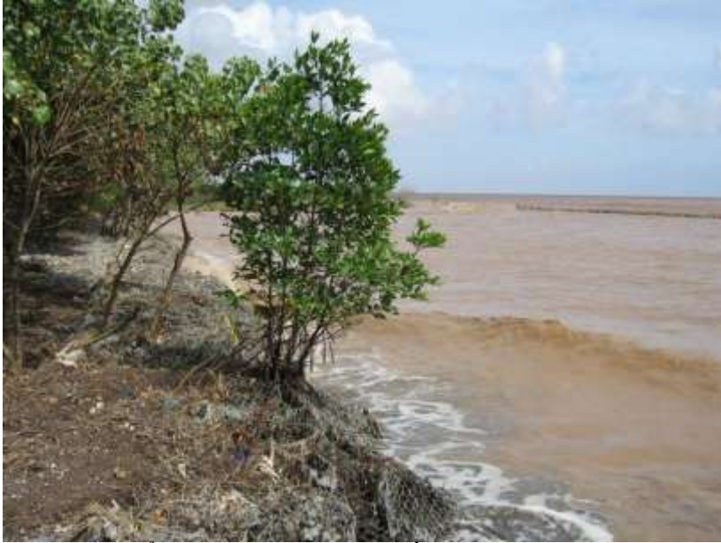
Hình 5: Bờ biển bị xói mòn, bảo vệ bằng rọ lưới thép
