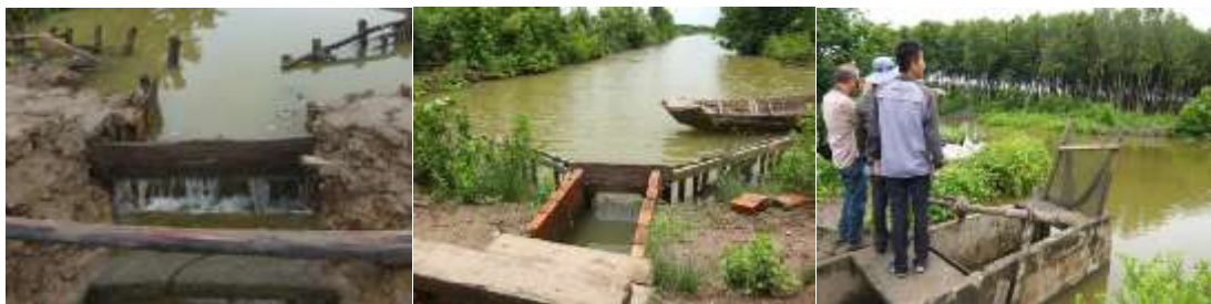
Figure 8. Cống thoát nước tại ao nuôi quảng canh ở các huyện phía nam. Thiết kế cống ảnh hưởng đến sự thay đổi nước dựa vào thủy triều, nếu cống bị rò rỉ thì mực nước sẽ biến động theo thủy triều. Kích thước, vị trí, số lượng cống cũng ảnh hưởng đến sự tuần hoàn nước và các yếu tố hòa tan trong nước.
