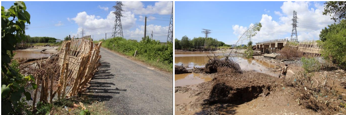
Hình 16a và 16b: Xói lở trầm trọng tại cầu và đê (Hình: Thorenz)
