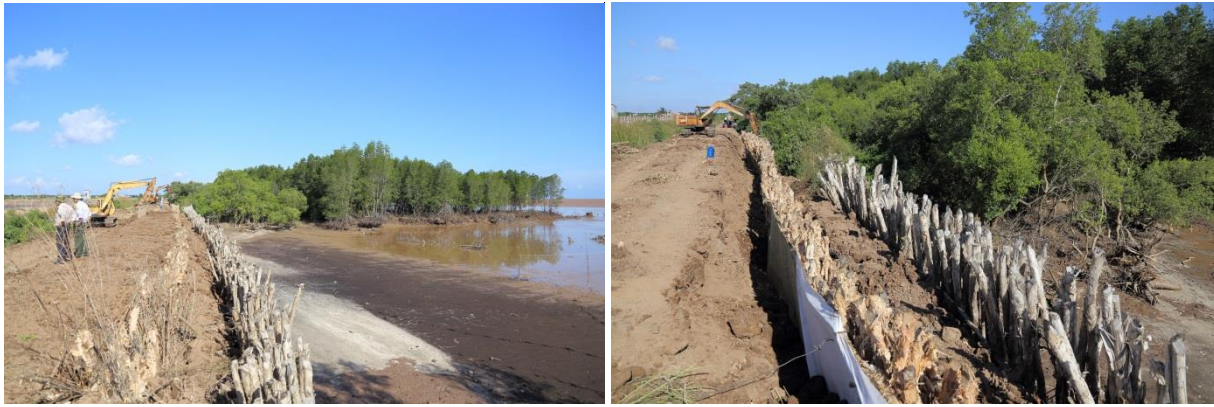
Hình 17a và 17b: Khu vực nâng cấp đê sử dụng hai hàng cọc ở tỉnh Sóc Trăng (Hình: Thorenz)
